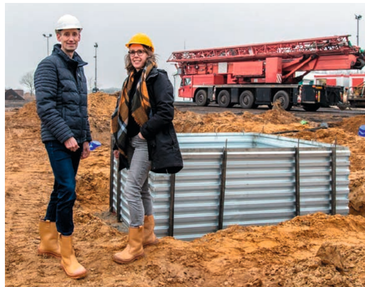
Projectmanagers Nieuwbouw Jessica Roelofs en Sebastiaan Endeman op de bouwlocatie waar het nieuwe, duurzame Slingeland Ziekenhuis naar verwachting medio 2027 haar deuren opent.
